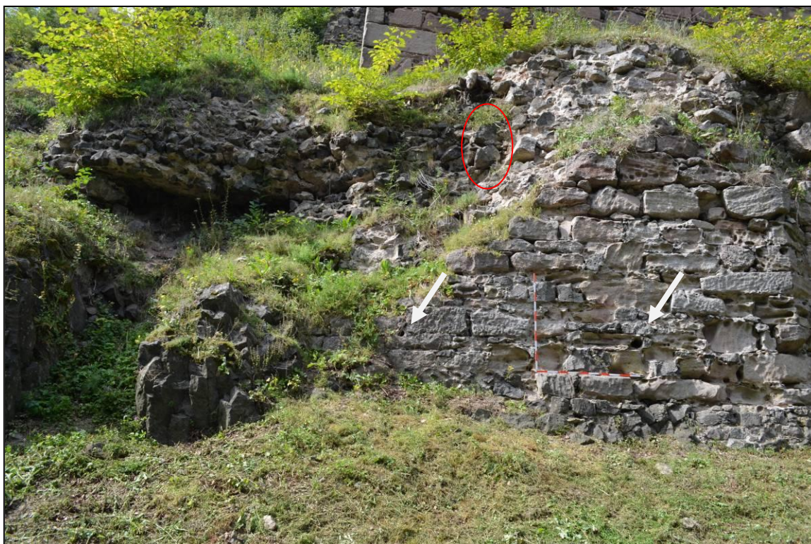
Obr. 2 Stávající stav opravované části okružní hradby v úseku pod „Velkou“ věží. Šipky ukazují na otvory, zřejmě po lešení. Červeně je zvýrazněn dochovaný líc první stavební etapy tohoto úseku.
