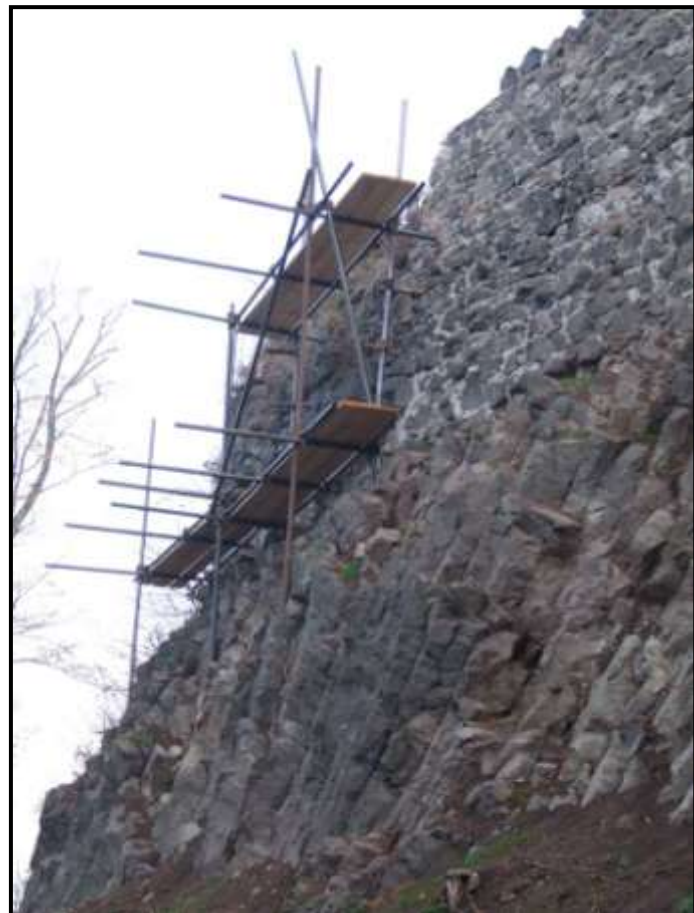
Montáž pomocného lešení druhé části oprav I. etapy statického zajištění okružní hradby.
